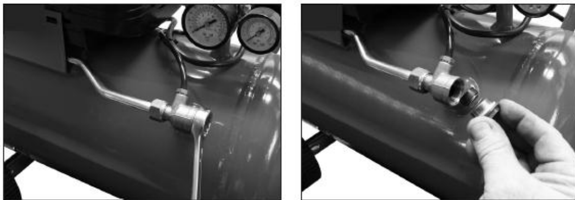
Рисунок. Очистка датчика давления воздуха.
